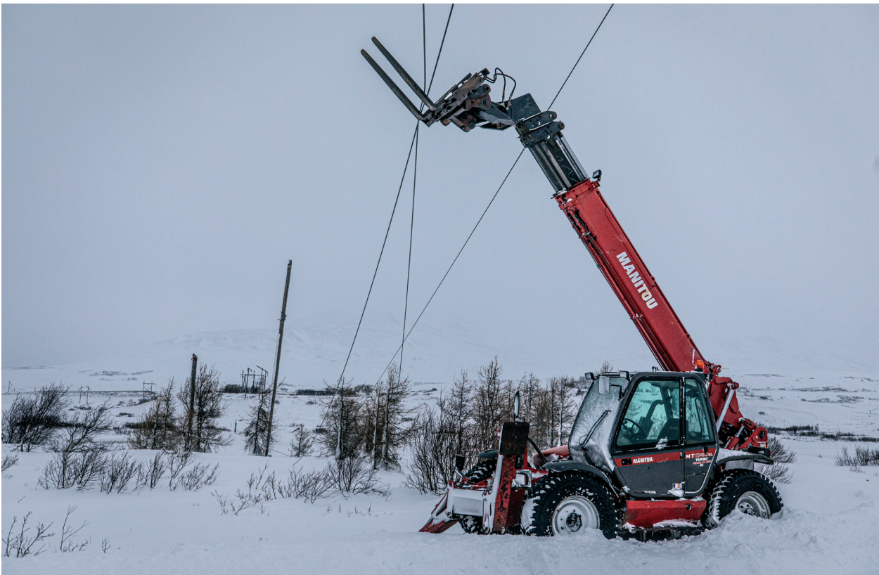
Vinnuvél ber uppi rafmagnslínur utan Dalvíkur eftir að staurar brotnuðu í ofsaveðri um miðjan desember 2019. Ljósmynd: Auðunn Nielsson.
